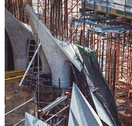
Columnas y capiteles de hormigón blanco de la Sala Crucero. Las columnas se han hormigonado in situ con moldes de poliéster, y los capiteles se han prefabricado con moldes de poliéster en el templo y se han elevado hasta el lugar correspondiente mediante la grúa.
